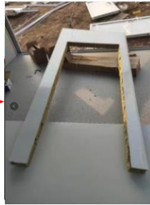
将门洞墙板放入排水沟的狭缝中，在门洞的内侧安装门支架。
